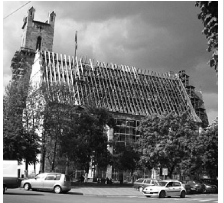
Die Dacharbeiten an der evangelischen Stadtpfarrkirche in Bistritz sind erfreulich weit fortgeschritten. Foto: Lucian Moise
